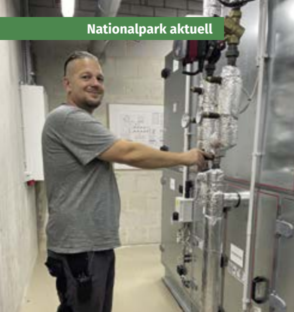
Alexander Jehle an einem technischen Herzstück des Besucherzentrums: Alles muss reibungslos laufen
